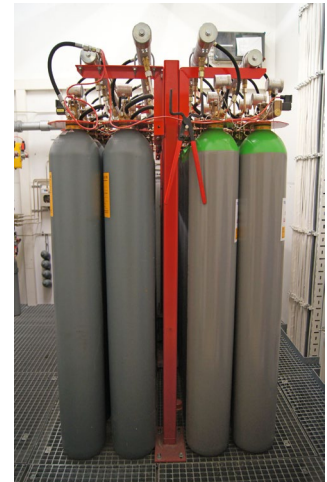
Abb. 62 Flaschenstation einer Gaslöschanlage
