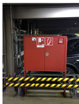
Abb. 50 Vor Beschädigungen und Witterungseinflüssen geschützte Feuerlöscheinrichtungen
